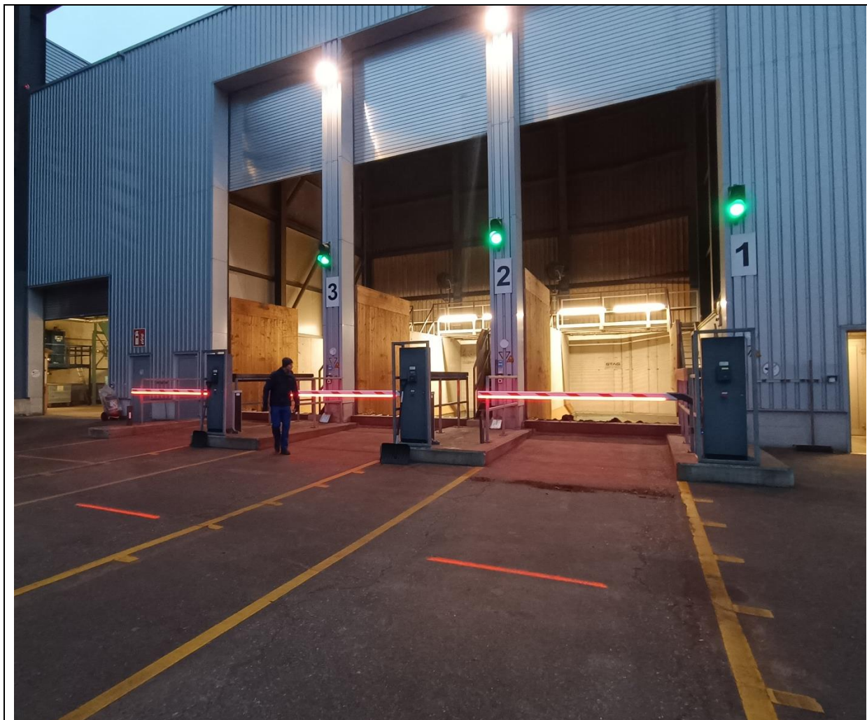
3x Komplettsystem Schranke mit LED und Scanner
